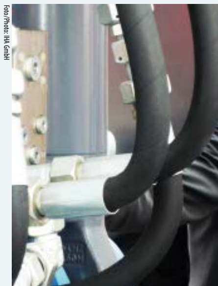
» Abb. 3: Nicht anforderungsgerechte Verlegung
