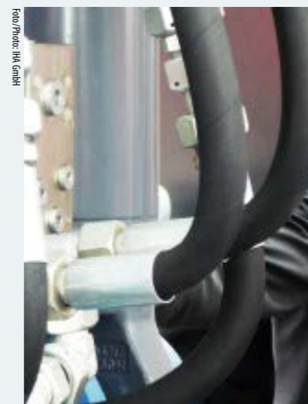
▶▶ Abb. 3: Nicht anforderungsgerechte Verlegung
