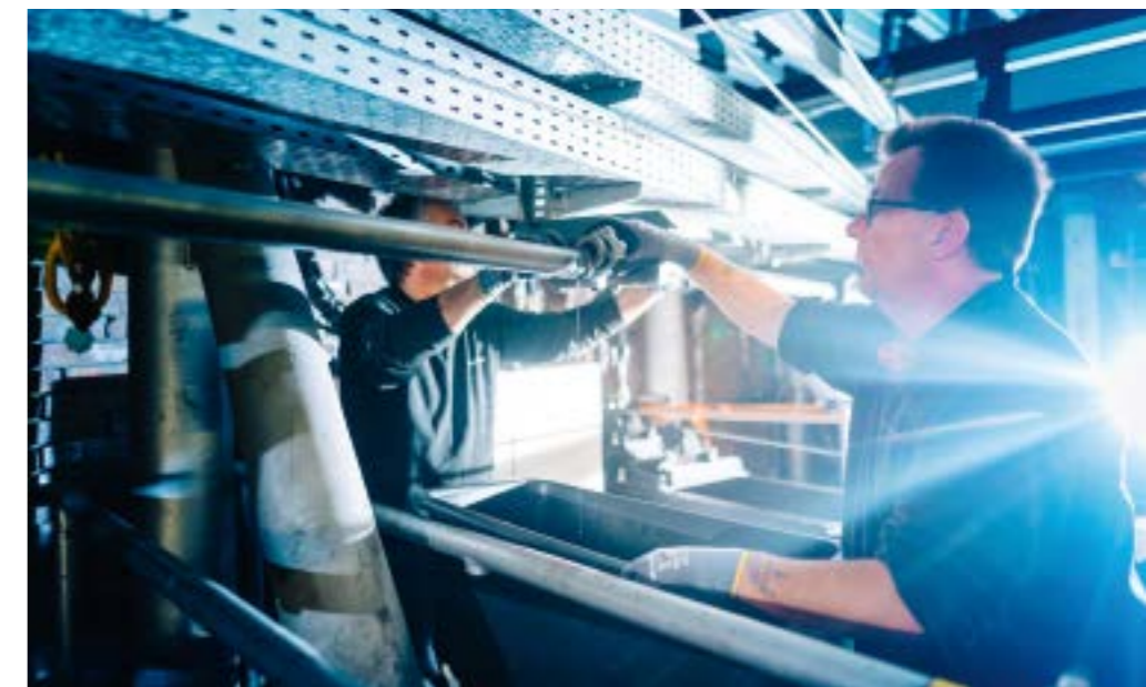
» Die 5 m langen Leitungen werden abgenommen, in einen Nebenraum geschoben und die Anschlüsse in der Wand abgedichtet. » The five-metre-long cables are removed, shifted into an adjacent room, and the connection points in the wall sealed.
